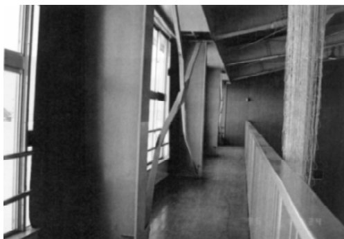
(a) 座屈したブレース 1)
